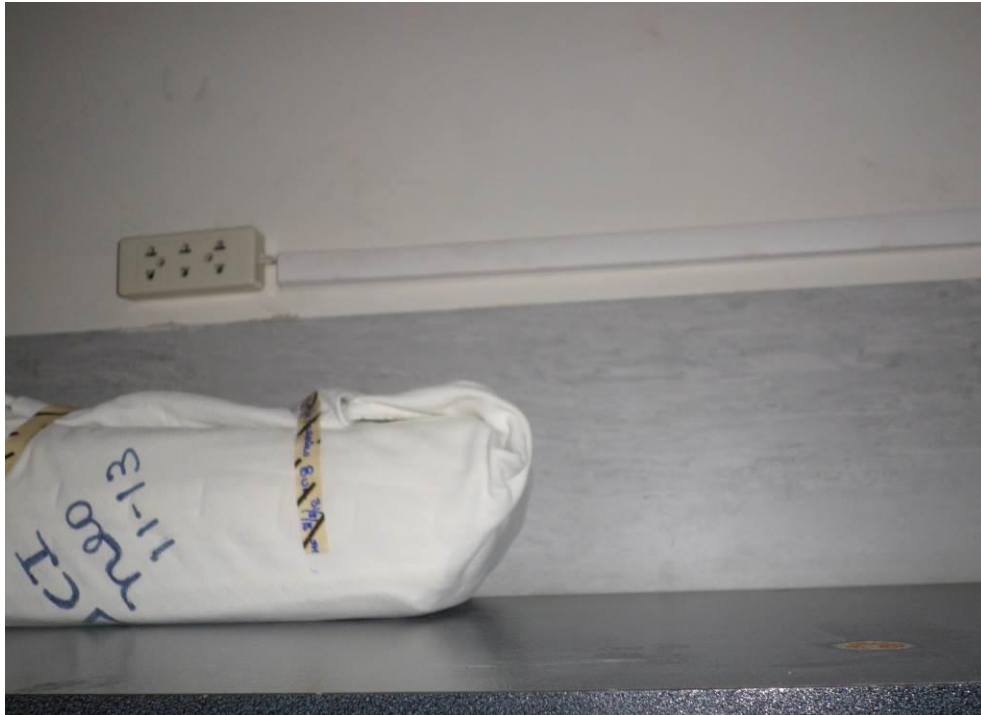
Tomacorriente y cableado sobre puesto
