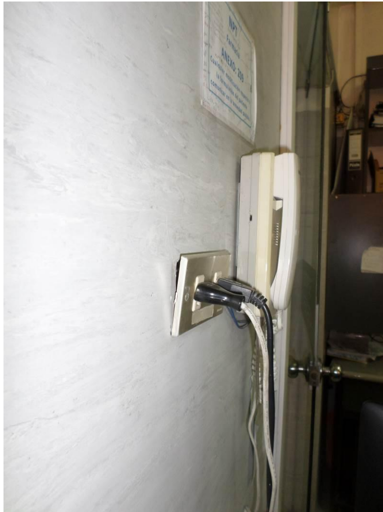
Placa de tomacorrientes sueltos
