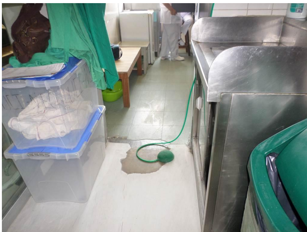
Piso de Vinílico Deteriorado
