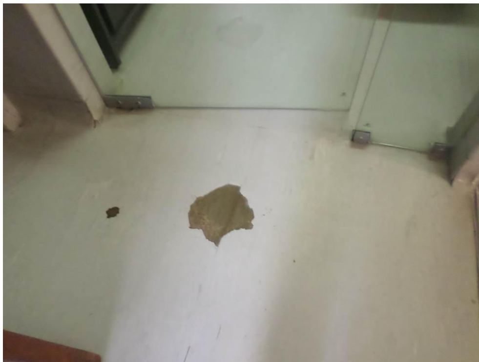
Piso de Vinílico deteriorado
