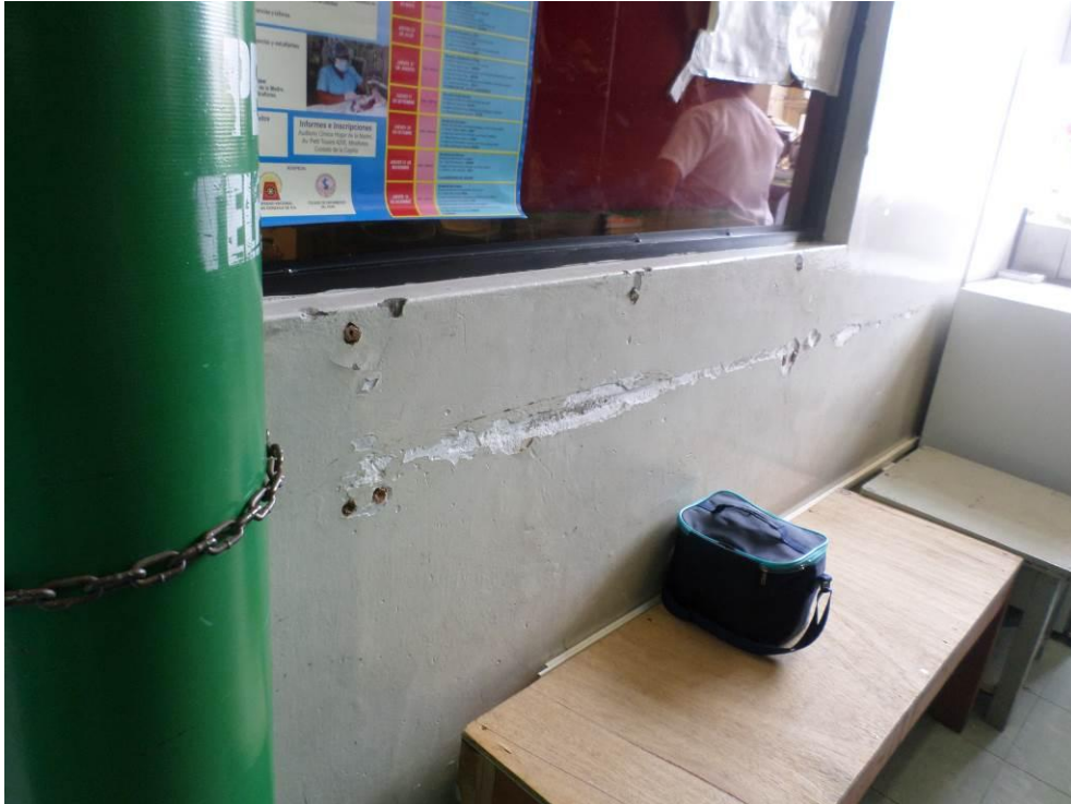
Muros con agujeros deteriorados
