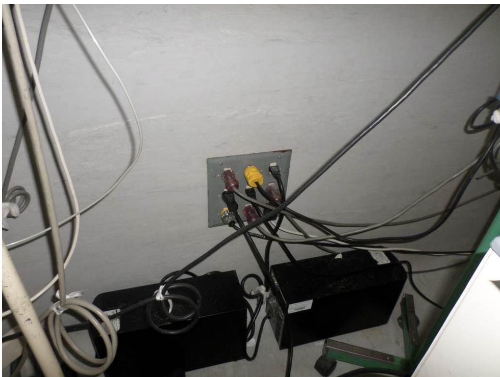
Tomacorrientes múltiples insuficientes
