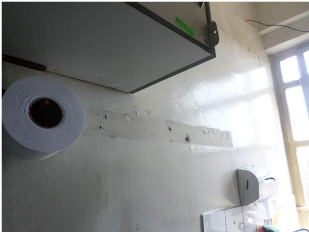
Muros con Agujeros
